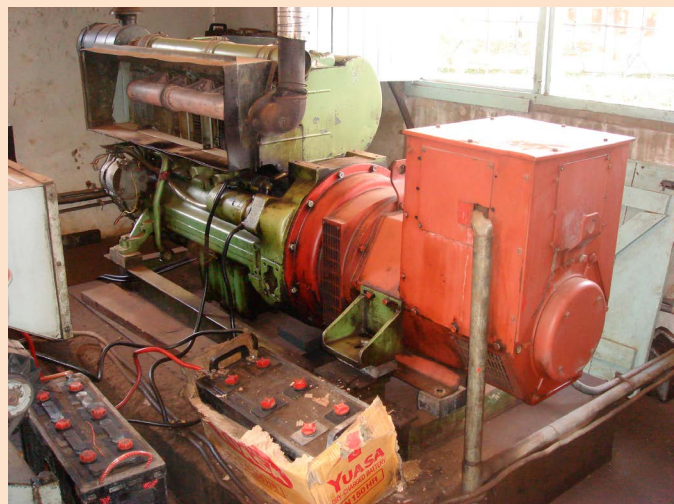
Der alte Notstromgenerator war in einem erbärmlichen Zustand.
