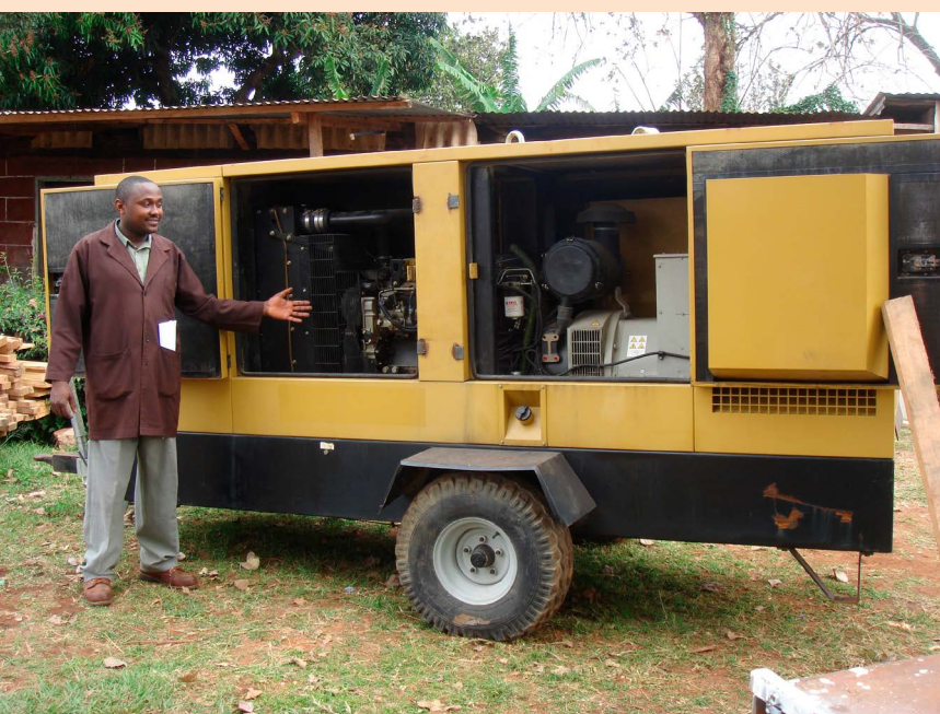
Der Spitalelektriker, Herr Lyakuwa, freut sich über den fast neuwertigen Generator!
